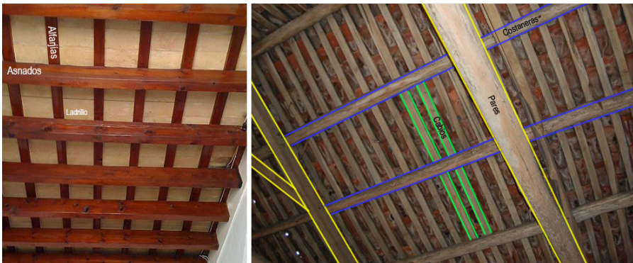
Figura 6. Izquierda: techo compuesto por asnados, alfarjías y ladrillo por tabla. Derecha: tejado a dos aguas de par y nudillo, con costaneras, cabios y tejas (María Núñez-González).
